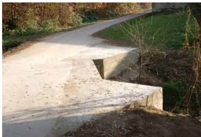
Saniral se je poškodovani most proti h.št. 10. (Foto: M. Žökš)
